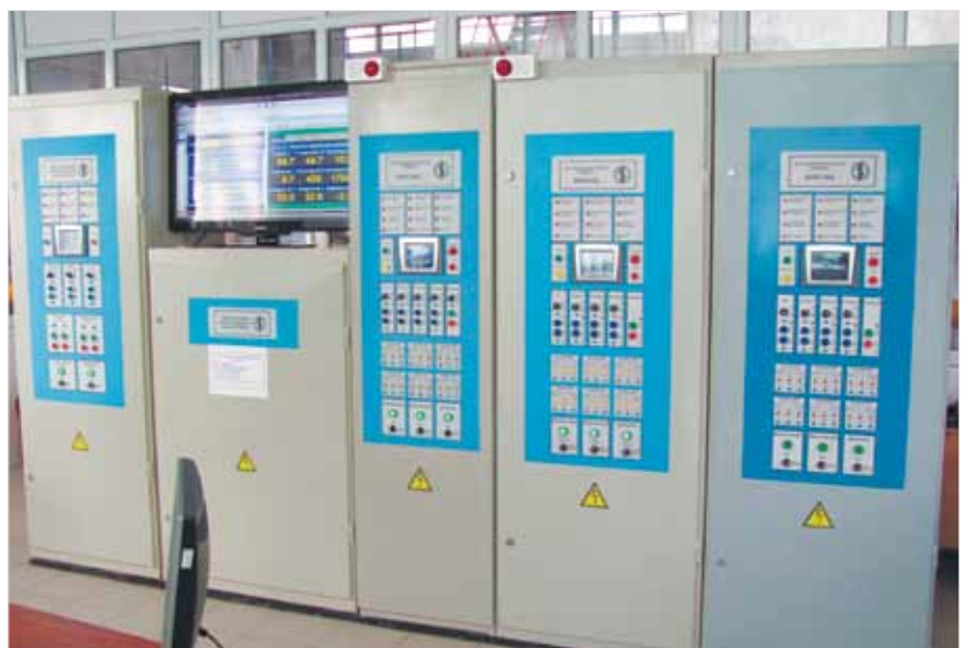
Автоматизированное рабочее место оператора котельной
